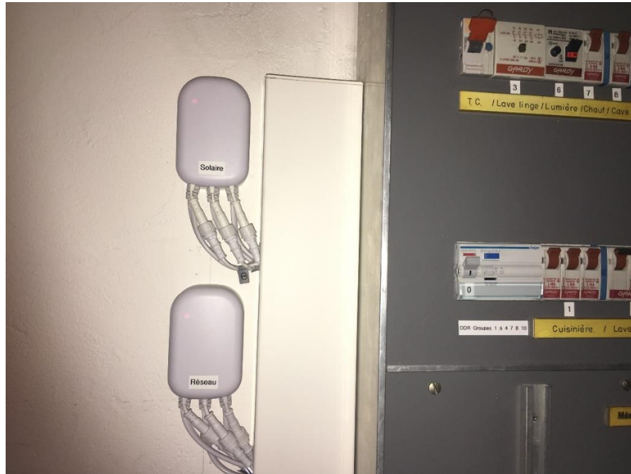
Figure 3 : tableau électrique avec compteurs d'énergie 1) solaire et 2) réseau. (Aeotec- Compteur de consommation électrique Z-wave Plus 3 pinces (60A, GEN5))
